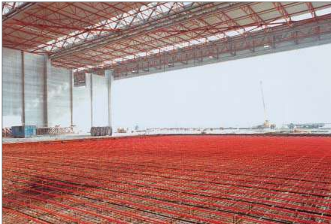
Рис. 9-1 Напольное отопление в промышленном цехе
